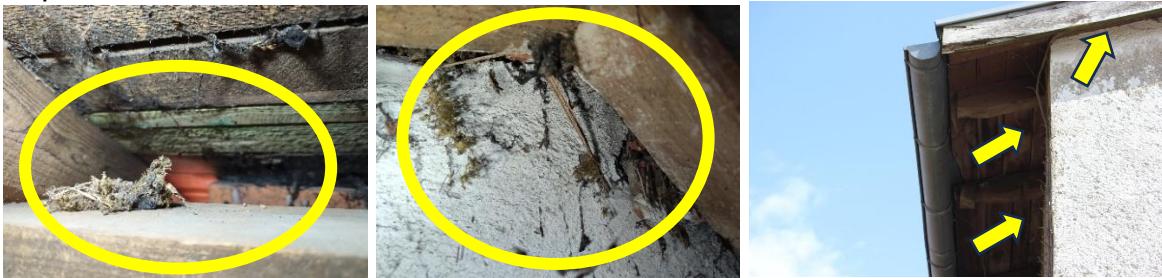
Bsp. 03.12.2024 Gerätehaus Feuerwehr Nistmaterial / Quartierbereiche im maroden Dachbereich / Traufe
