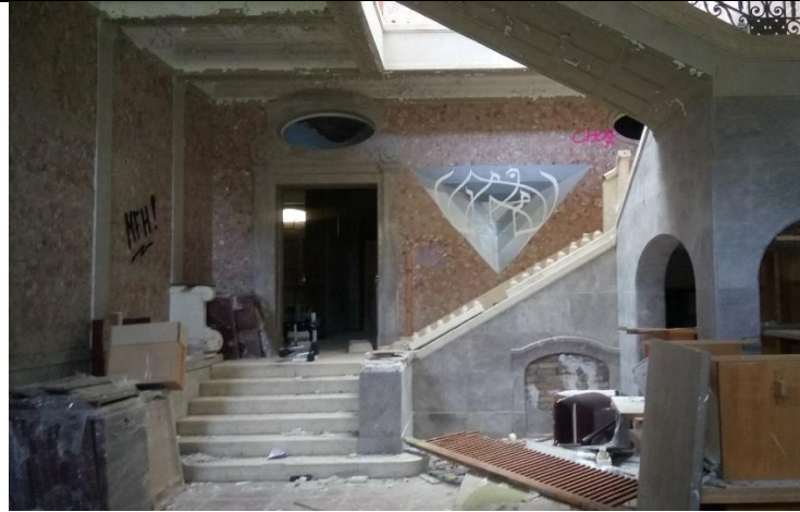
Spuren des verheerenden Vandalismus im Innern der Villa Baltic
